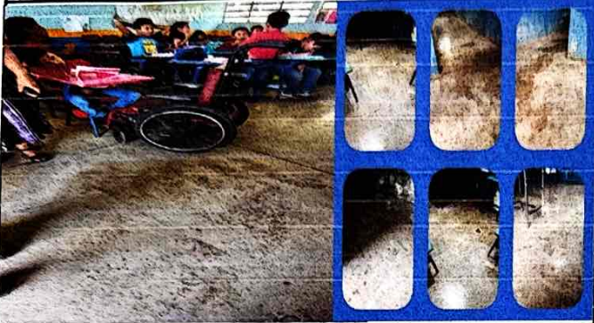
Foto 1: SUSTITUCION DE PISO (PISO EN MAL ESTADO)
