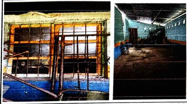
Foto 2: Sustitución de dos ventanas, balcon y piso. (Piso en mal estado)
